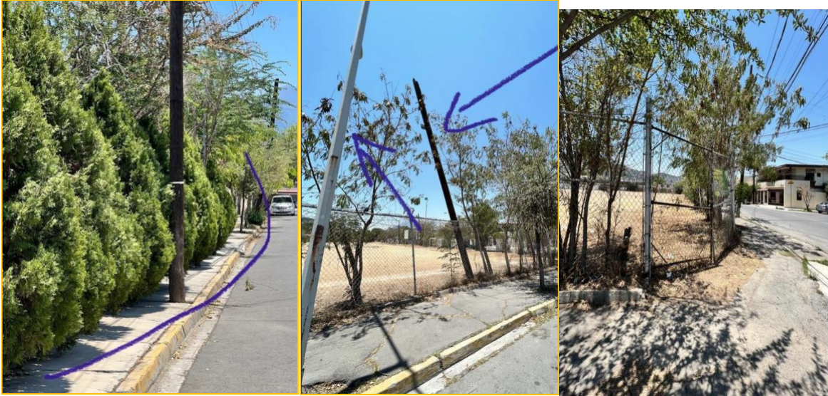
Banquetas no caminables e inseguridad por postes en mal estado.
