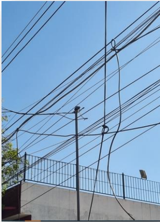
Foto 4: Cables colgando y rotos.
