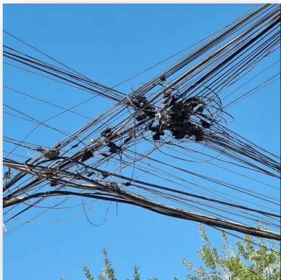
Foto 14: Cables y más cables.
