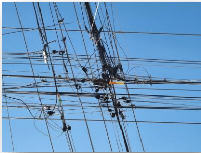
Foto 5: Saturación de Cables
