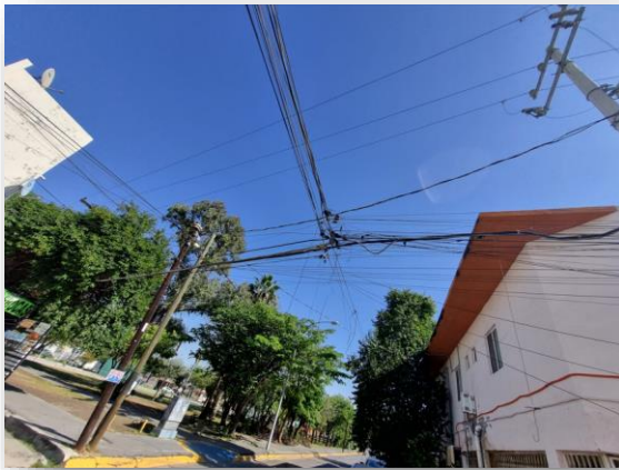
Foto 15: Cables por todas partes.
