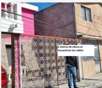
Foto 3: Cables a menos de 2 metros de altura
