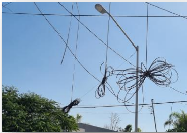
Fotos 1: Cables Colgando
