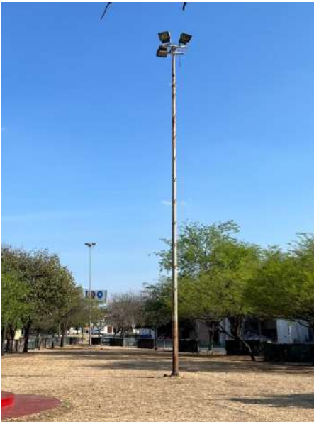
Las luminaria de torre pintar de gris.
